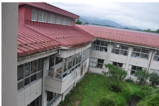
大規模改修が待たれる片品中学校(外部)
