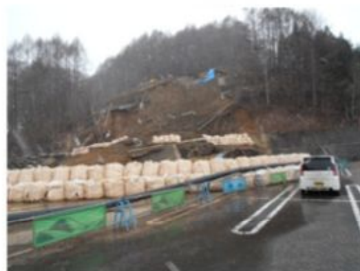
岩鞍の災害現場 (道路災害復旧 第15号)
