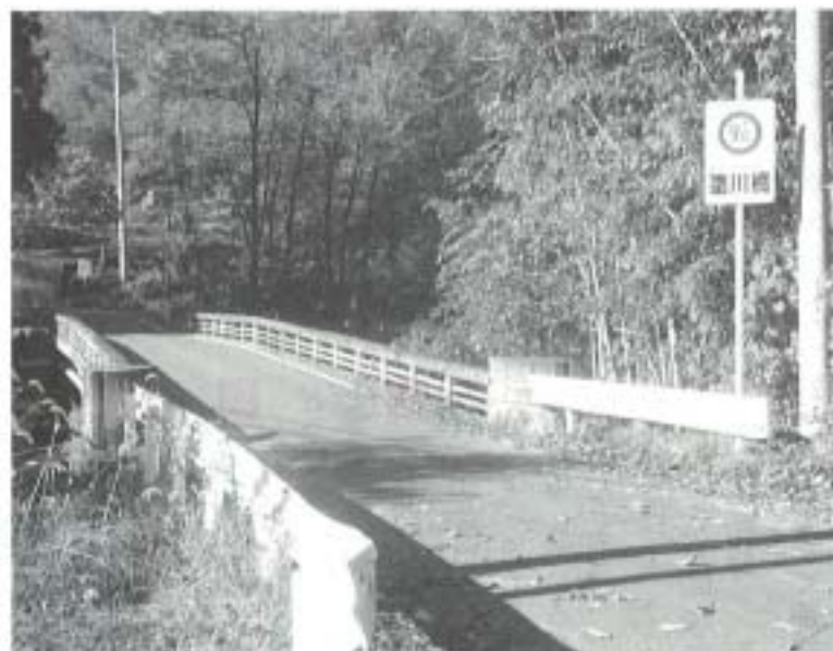
重量制限されている塗川橋
